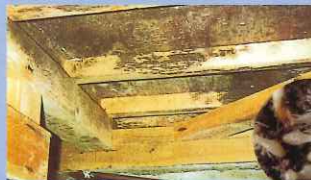
■木材腐朽菌に侵された床下
